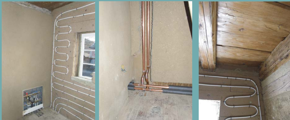
Vlevo detail měděných izolovaných trubkových rozvodů topné vody. Uprostřed rozvaděč stěnového vytápění a vpravo detail rozvodu topných trubek na hrázděné stěně izolované dřevovláknitými deskami.
