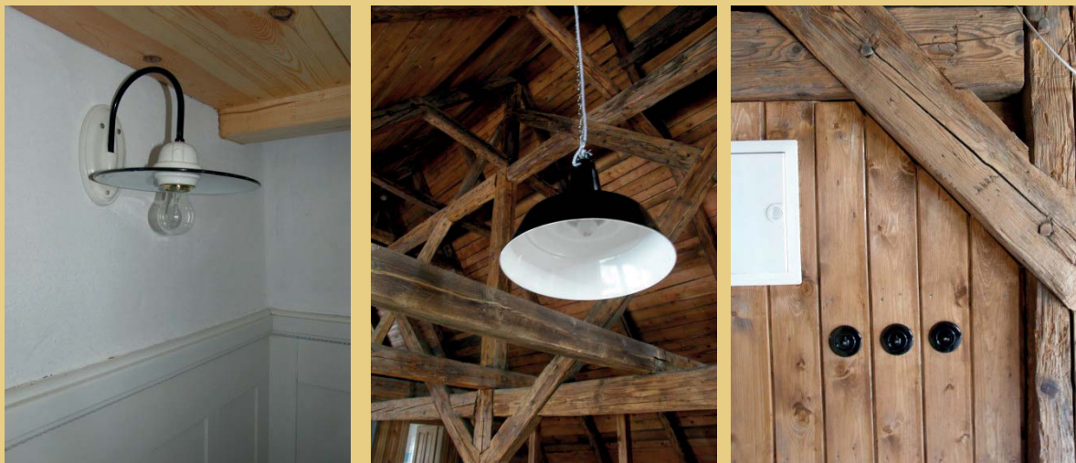
Neu installierte Retro-Leuchten im Ober- und Dachgeschoss. Runde Retro-Lichtschalter an der neu erstellten WC-Trennwand im Dachgeschoss.
