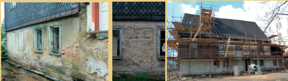
Zustand des Putzes an der Westseite des Hauses im Juli 2010 und während der Bauarbeiten im April 2011.
