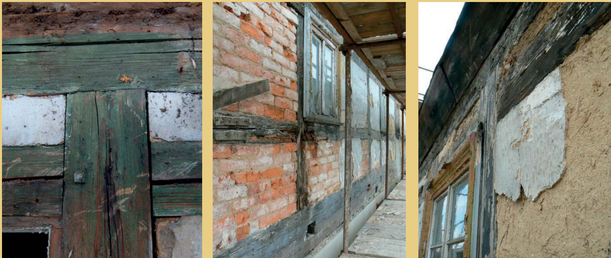
An den Balken sind alte Farbanstriche erkennbar. Unter dem abfallenden Kalkputz treten Ziegel- und Lehmausfachungen zutage.
