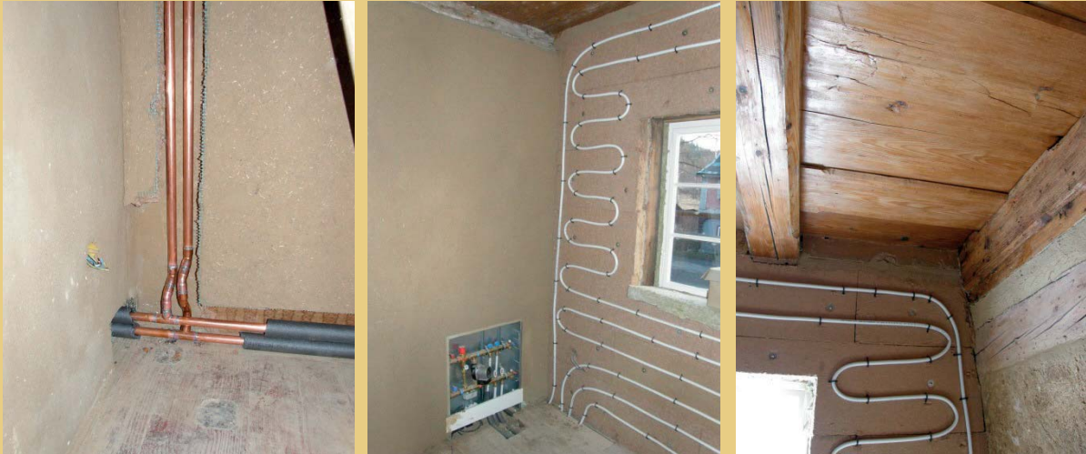
Foto links: Detail der isolierten Kupferrohre. Foto Mitte: Heizungsverteiler der Wandheizung. Foto rechts: Detail der Wandheizung auf der mit Holzfaserplatten isolierten Fachwerkwand.
