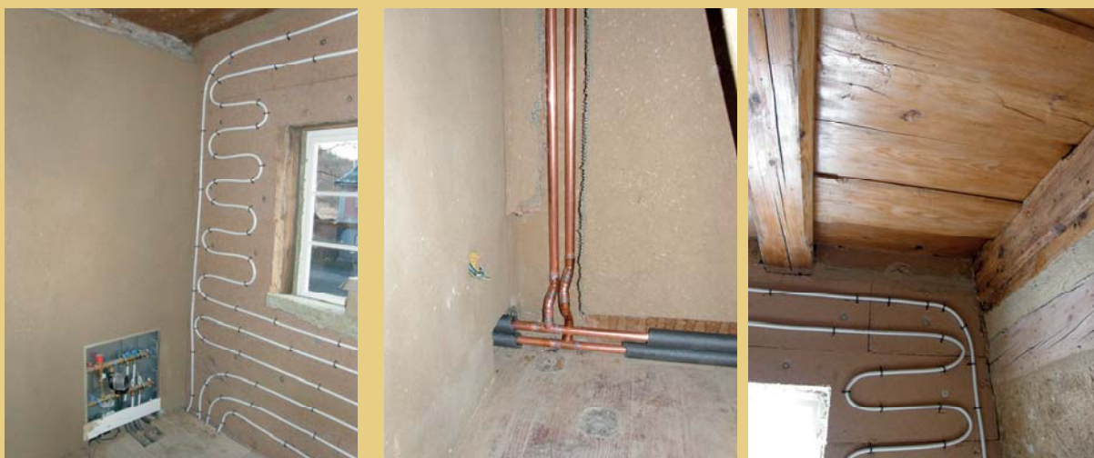
Vlevo detail měděných izolovaných trubkových rozvodů topné vody. Uprostřed rozvaděč stěnového vytápění a vpravo detail rozvodu topných trubek na hrázděné stěně izolované dřevovláknitými deskami.
