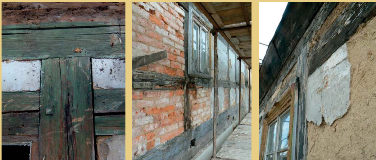
Na trámech jsou patrné barevné nátěry, pod opadávající vápennou omítkou se objevuje cihelné zdivo i hliněné vymazávky.
